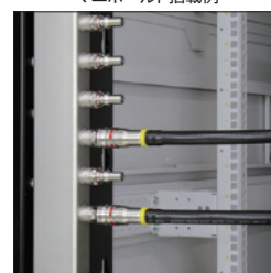
マニホールドからGPUサーバーへの接続
